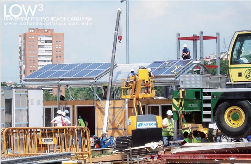
Vista general del montaje del prototipo en la Villa Solar (Madrid)
